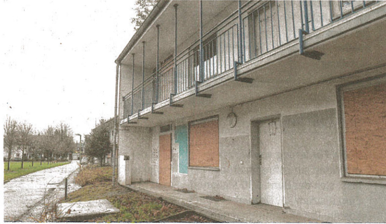
Wo heute die ehemaligen Flüchtlingsunterkünfte an der Straße Auf'm Bögel stehen, soll nach deren Abriss Mehrgenerationenwohnen entstehen. FOTO: VLADIMIR WEGENER
